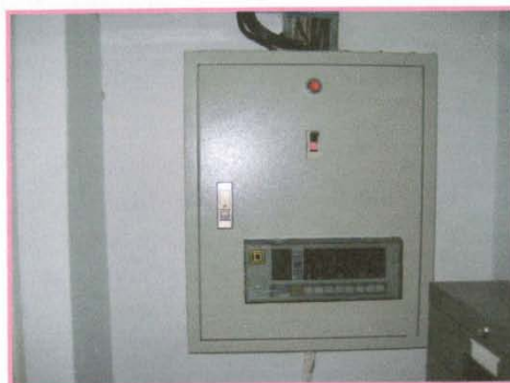
ปัจจุบันตู้ควบคุมไฟฟ้าใช้การได้ดี
